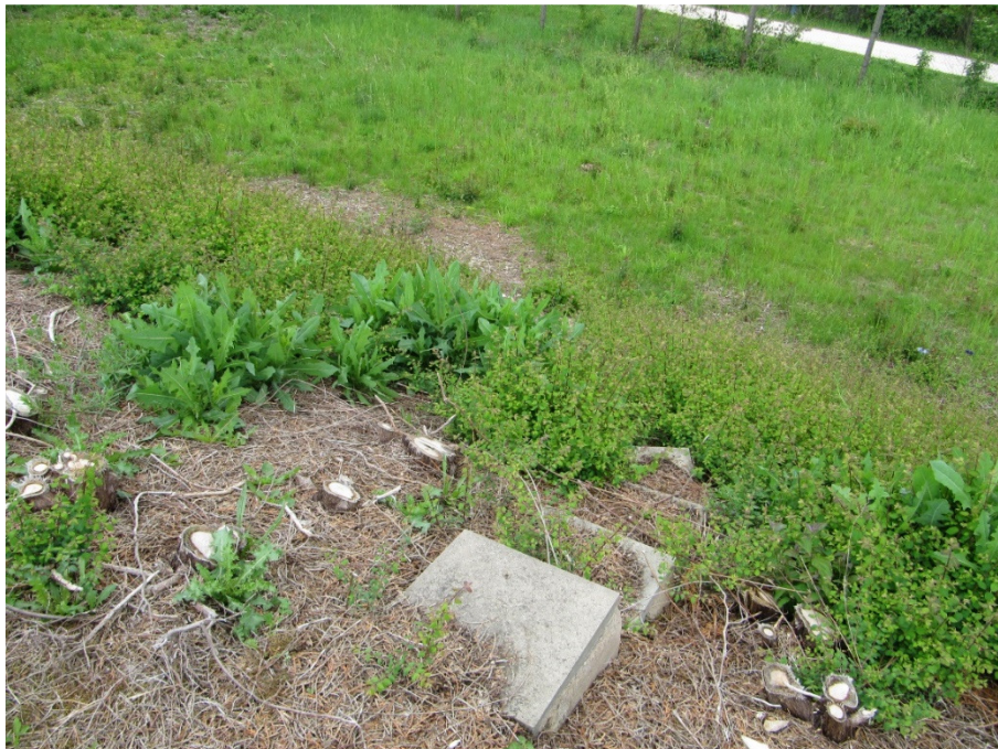
Foto 2: Treppenabgang in der Böschung, lückige Vegetation
