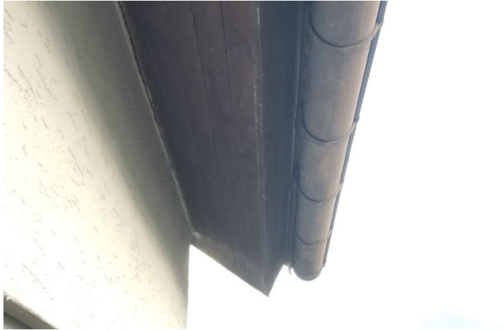
Abbildung 4: Traufkasten am Wohnhaus mit Lebensstättenpotential am Wohnhaus (hier Südseite)
