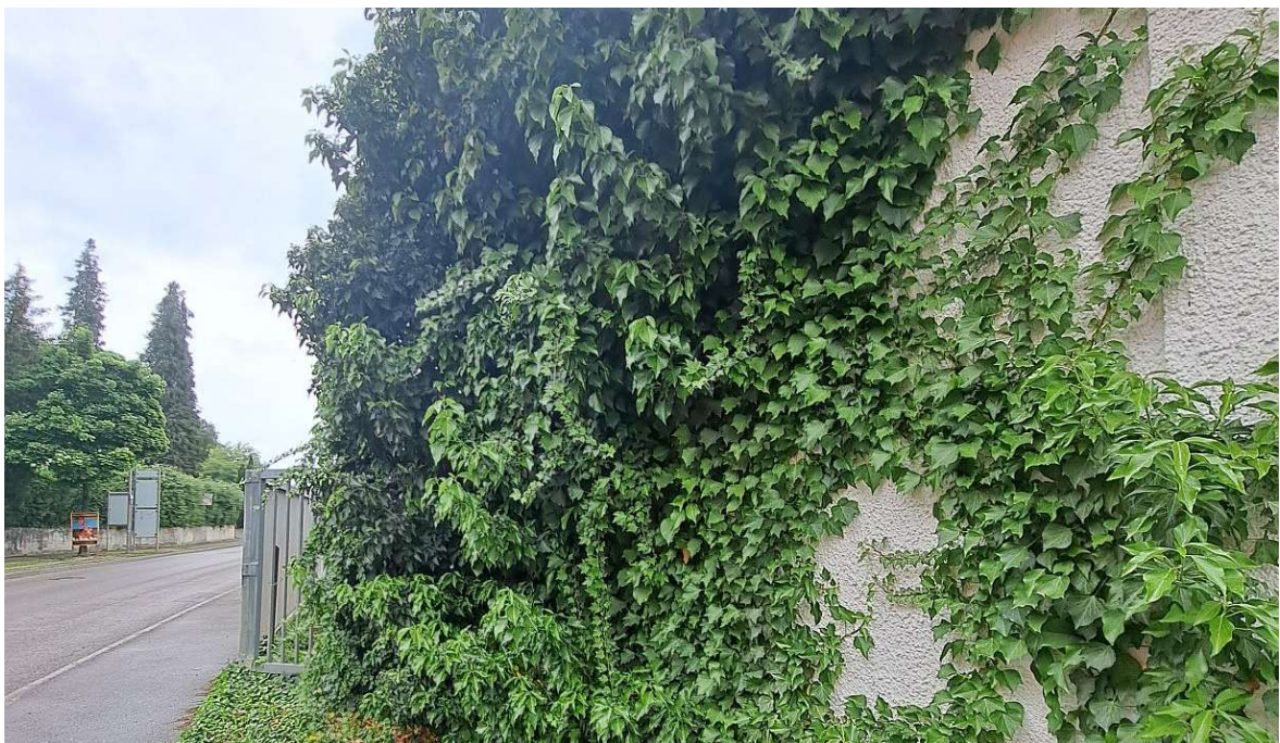
Abbildung 6: Bewachsene Fassade im Nordwesten.
