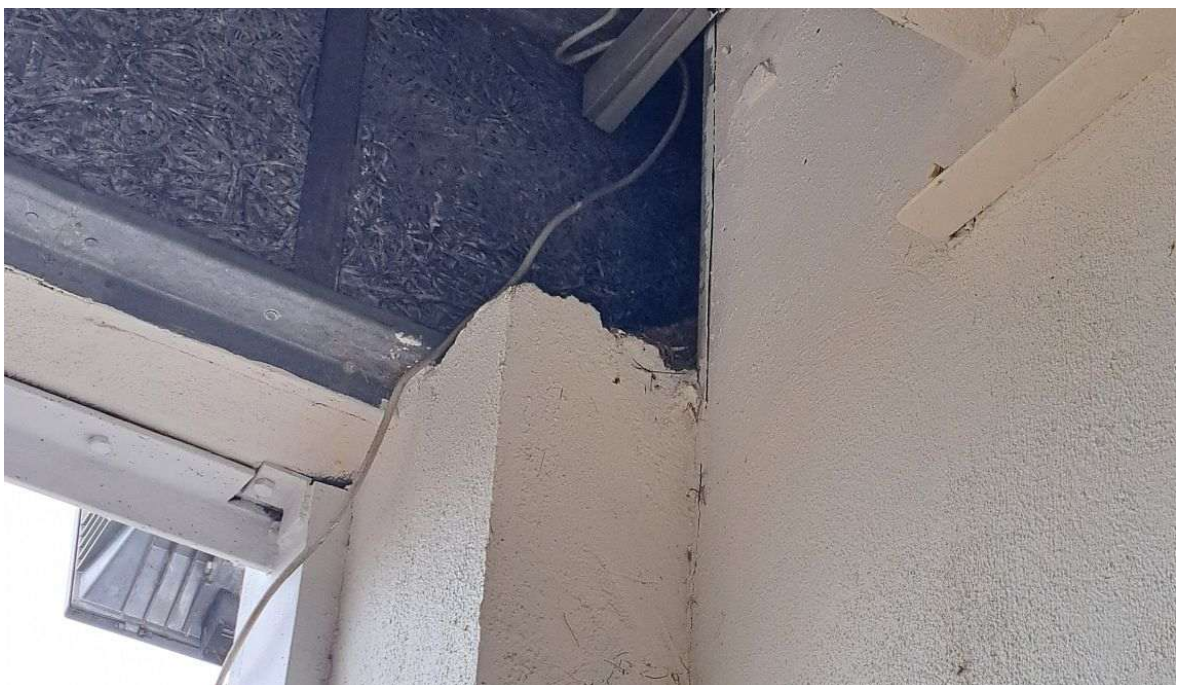
Abbildung 29: Hausrotschwanz Nest am südlichen Rolltor des östlichen Lagergebäudes. (Quelle: Eigene Aufnahme vom 22.05.2025).
