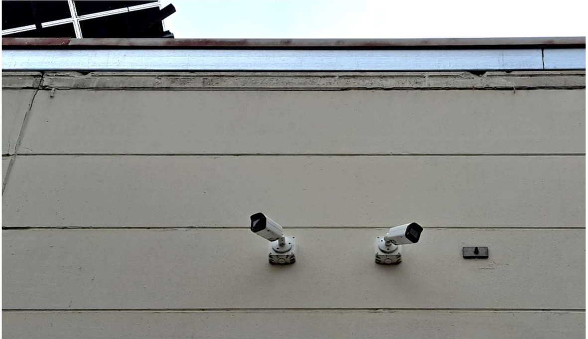
Abbildung 10: Öffnungen im Übergangsbereich der Fassade zur Dachkonstruktion mit ausgeformten Abrundungen im unteren Bereich. (Quelle: Eigene Aufnahme vom 22.05.2025).
