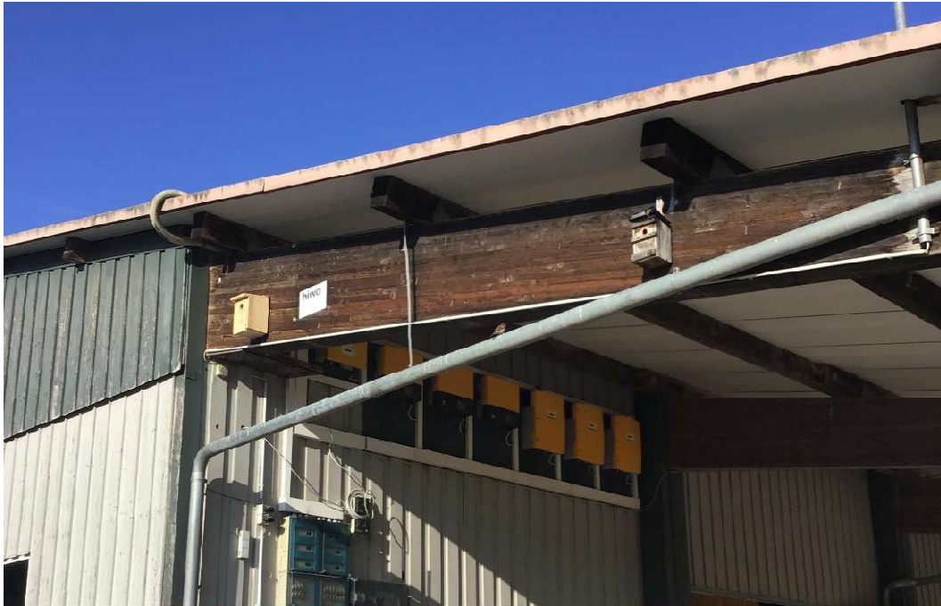
Abbildung 17: Zahlreiche Meisennistkästen an allen Gebäuden, teilweise besiedelt. (Quelle: Eigene Aufnahme vom 03.04.2025).
